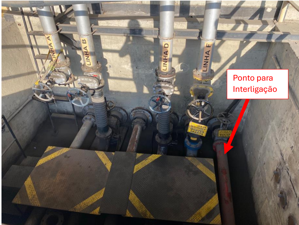
Fig.1 – Caixa de válvula onde deverá ser interligado o sistema de combate a incêndio
